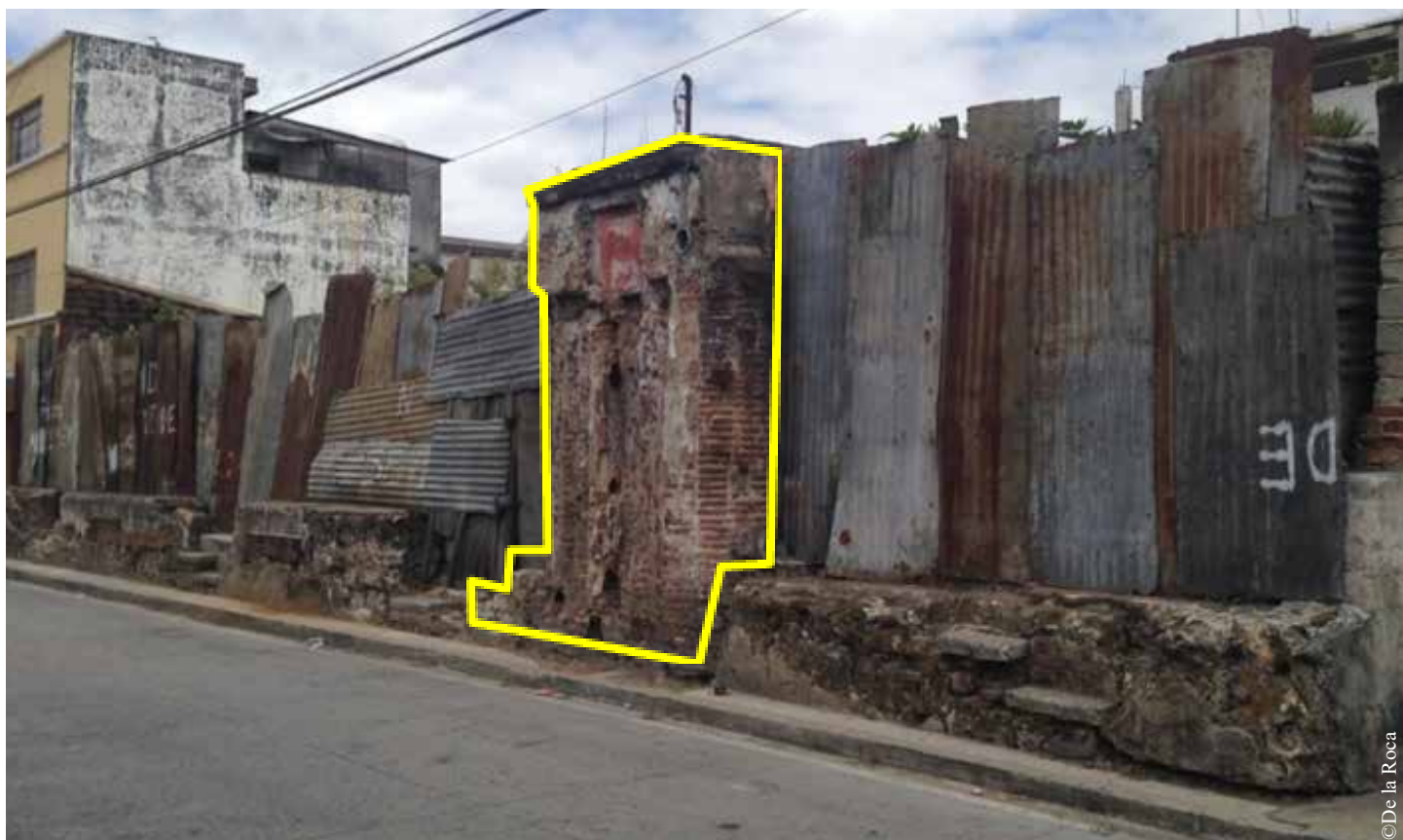
Figura 1. Caja de Agua. 40 años después del terremoto de 1976, aún no se ha reconstruido esta vivienda, (ubicada 100 metros al sur del templo de La Candelaria). Lo único que está de pie, es el depósito que abastecía de agua al barrio, conocido como la Caja de agua, considerado patrimonio arquitectónico. Nótese el mal aspecto físico y la nula salvaguardia del patrimonio. Fotografía captada el 11-marzo-2016, autor Leonel Alberto De la Roca Coronado.
