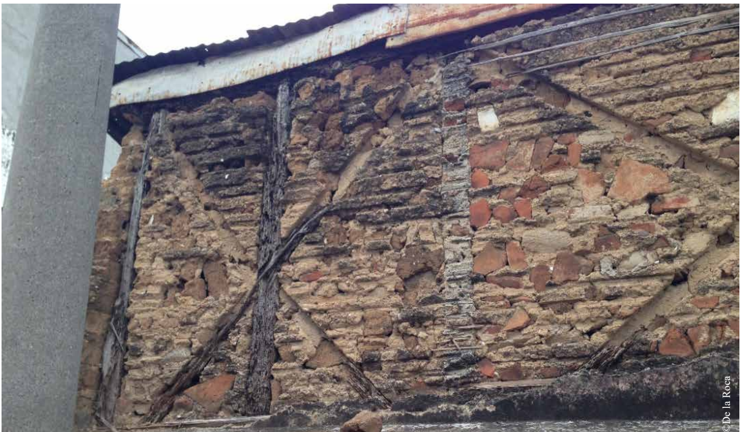
Figura 5. Detalle constructivo antiguo. Puede notarse que está pared construida con todo tipo de materiales de su época como adobes, barro cocido y piedra, reforzado con columnas y breizas de madera, está totalmente deteriorado (la madera estructural se destruyó por completo). En cualquier momento, con el menor esfuerzo sísmico este muro se perderá para siempre. Fotografía captada el 11-marzo-2016, autor Leonel Alberto De la Roca Coronado.
