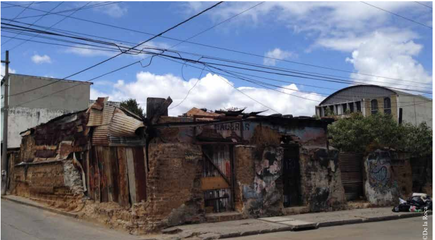
Figura 2. Propiedad privada. También destruida por el terremoto del 76. Ubicada una cuadra al oriente del templo de La Candelaria, en ruinas y deshabitada y sin reconstrucción. Es un peligro latente para los peatones. Fotografía captada el 11-marzo-2016, autor Leonel Alberto De la Roca Coronado.
